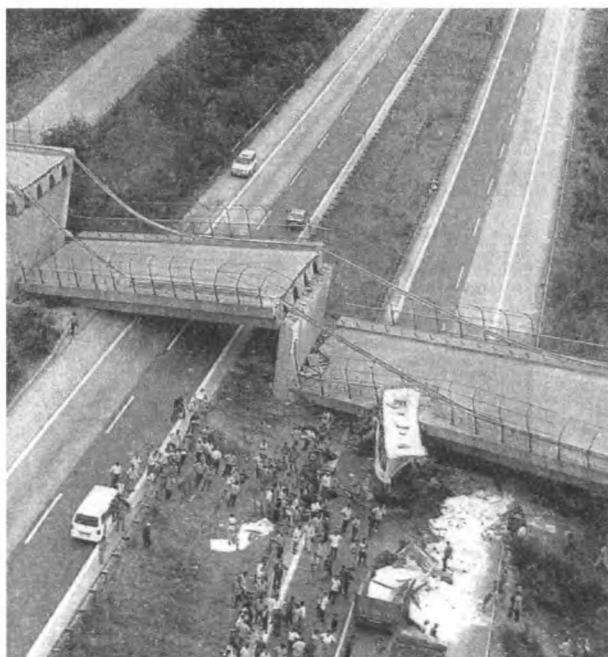
Мост после землетрясения в Турции, лето 1999 г.
